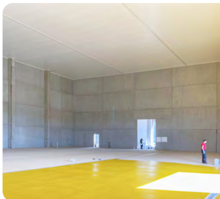
RenoPanel als hygiënisch plafond in een aardappel verwerkingsbedrijf.
